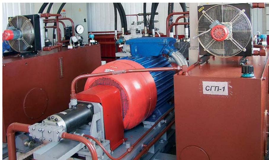
Фото 3. Станция гидрозапуска ГТУ
